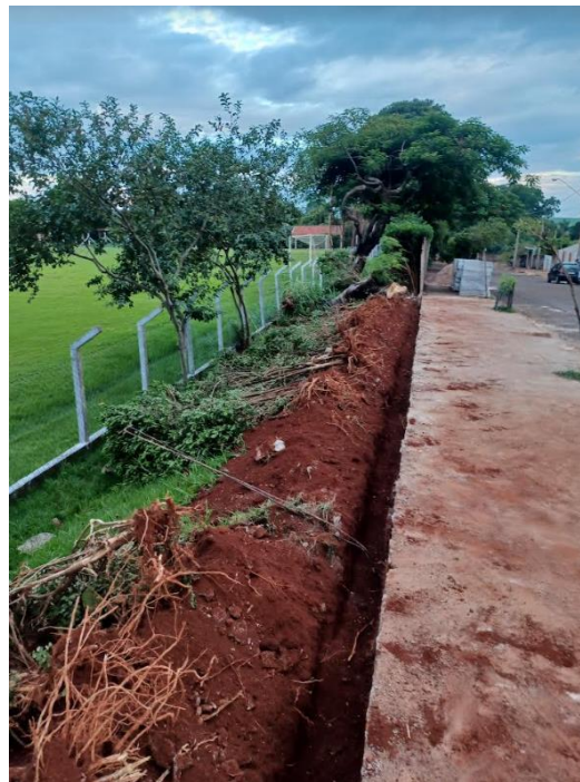
Figura 90. Detalhes dos trabalhos da zeladoria na reconstrução de 60 metros lineares de muro no CRT (Fevereiro de 2024)
