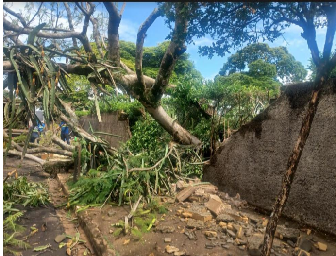
Figura 89. Detalhes da queda de árvore de grande porte (janeiro de 2024) e danos no muro do CRT (120 metros quadrados)
