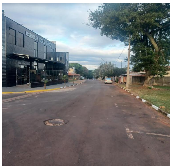
Figura 68. Detalhes da pintura das Sarjetas na Rua José Fazanaro (582 metros de guias e sarjetas no total dos dois lados – foto 29/05/2024) – proximidades da área verde do loteamento Recanto Feliz
